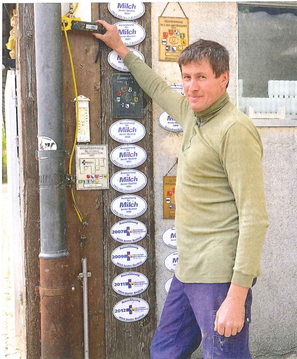
Thomas Jucker misst den Strom am zentralen Erdungspunkt. Es handelt sich um die Summe aller Fehlerströme aus dem ganzen Landwirtschaftsbetrieb.
